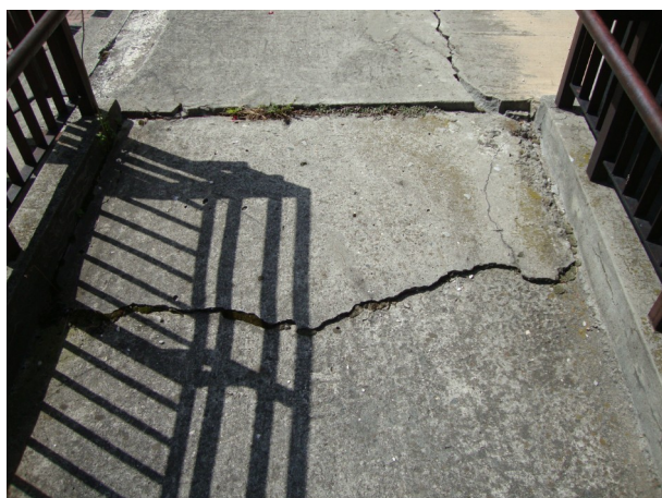
Fot. 3. Uszkodzenie warstwy wykończeniowej pochylni przy połączeniu z tarasem
