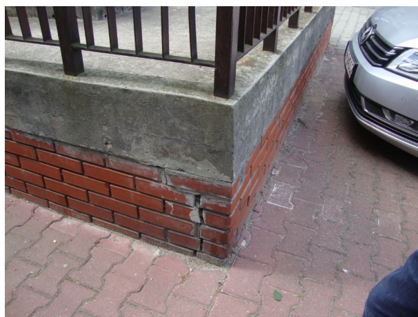
Fot. 10. Rozluźnienie struktury muru w miejscu podparcia narożnika pochylni od strony północno- wschodniej
