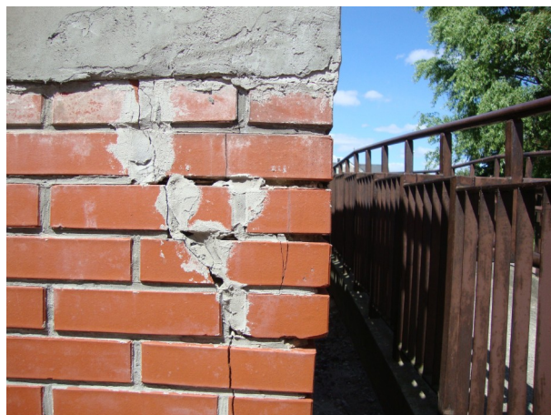
Fot. 6. Zarysowanie ceglanej podpory i poziome przemieszczenie się górnych warstw cegieł
