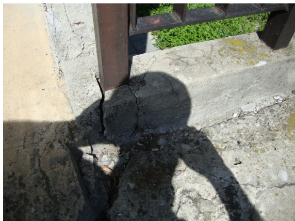
Fot. 5. Pęknięcia belki krawędziowej pochylni przy słupku balustrady
