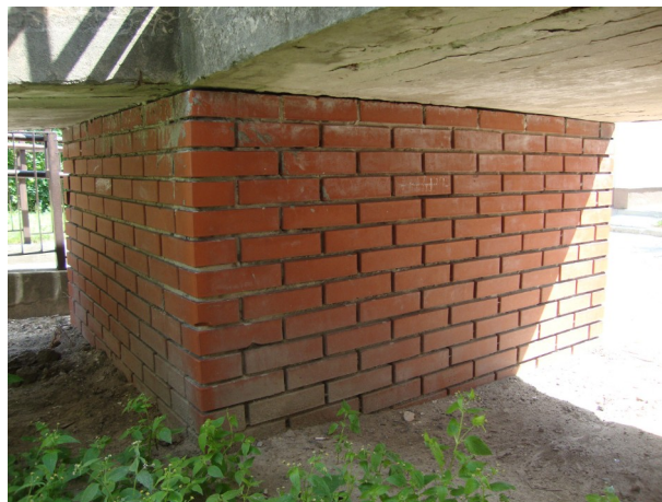
Fot. 8. Osiadły fragment podpory pochylni (pomiędzy murem a żelbetową płytą widoczna szczelina)
