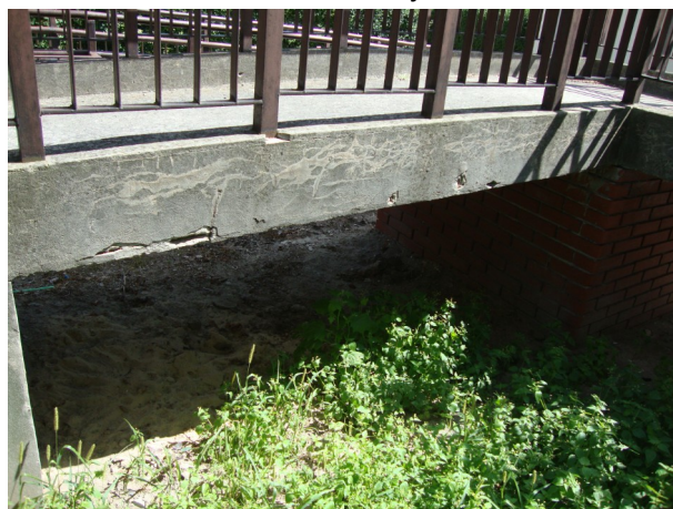
Fot. 12. Zarysowania skurczowe (powierzchniowe) bocznej części pochylni oraz ubytki otuliny zbrojenia
