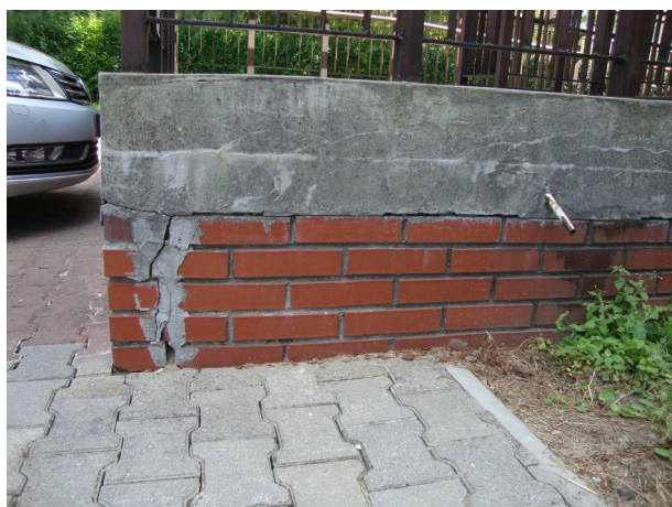
Fot. 9. Zarysowanie muru w miejscu podparcia narożnika pochylni od strony północno-zachodniej
