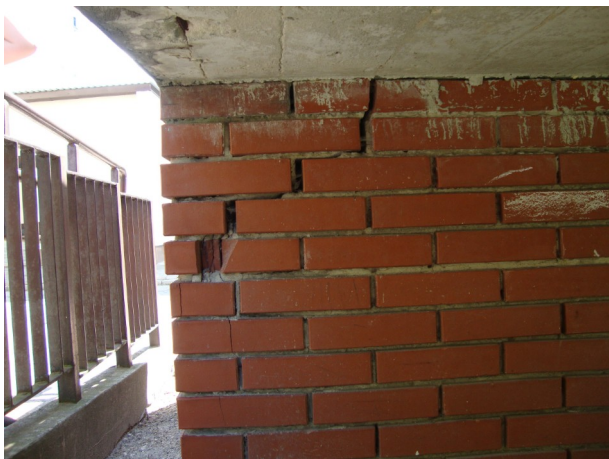
Fot. 7. Deformacja ceglanej podpory - przemieszczenie się górnych warstw cegieł
