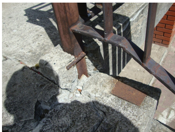
Fot. 4. Ubytek betonu na belce krawędziowej pochylni
