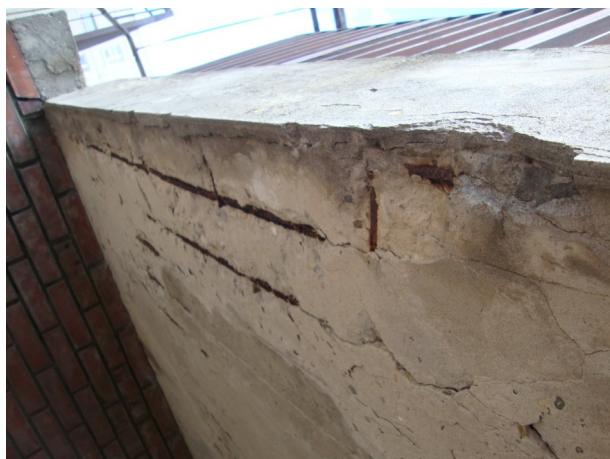
Fot. 11. Uszkodzenia powierzchni płyty od spodu, destrukcja otuliny zbrojenia oraz korozja prętów zbrojeniowych
